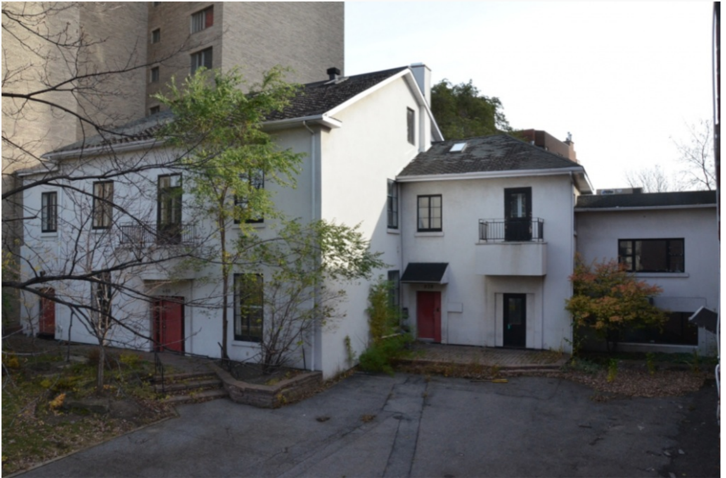
Vue d'ensemble de la propriété depuis la rue Cherrier. On peut noter l'usure des bardeaux du toit. (photo : Gabriel Deschambault)
